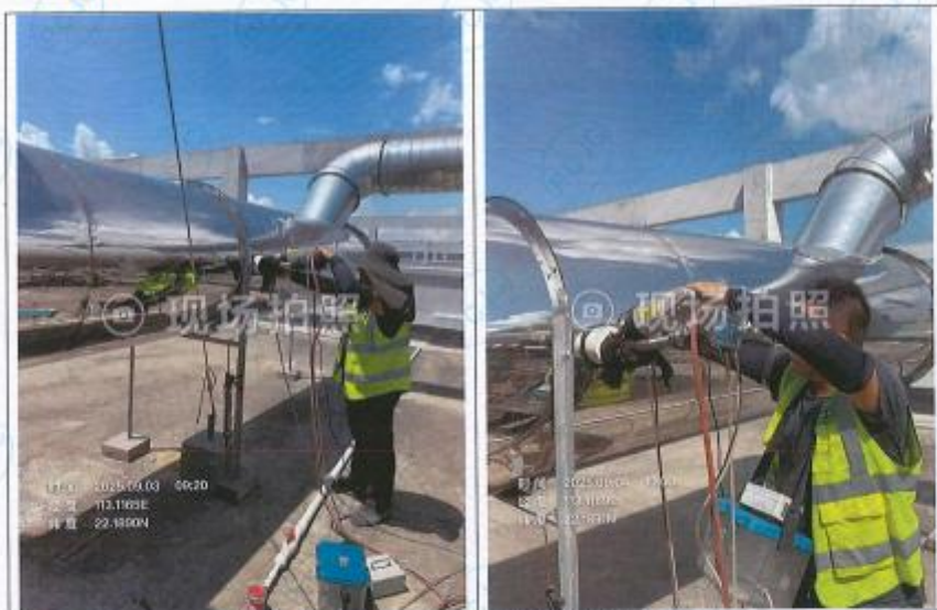
FQ-9-2439-02M 有机废气排放口处理前
