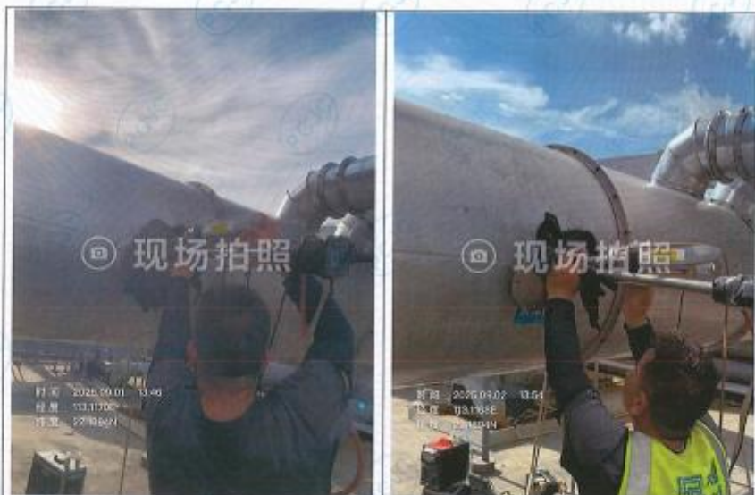
FQ-9-2439-02G 有机废气排放口处理前
