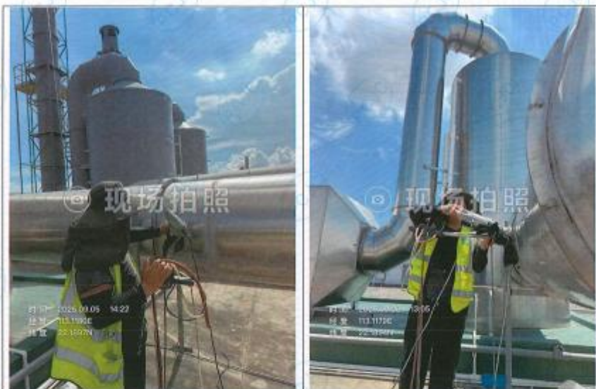
FQ-9-2439-02D 有机废气排放口处理前
