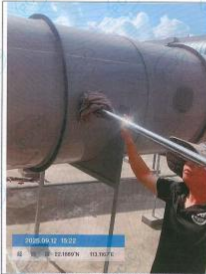
FQ-9-2439-02L 酸性废气排放口处理前
